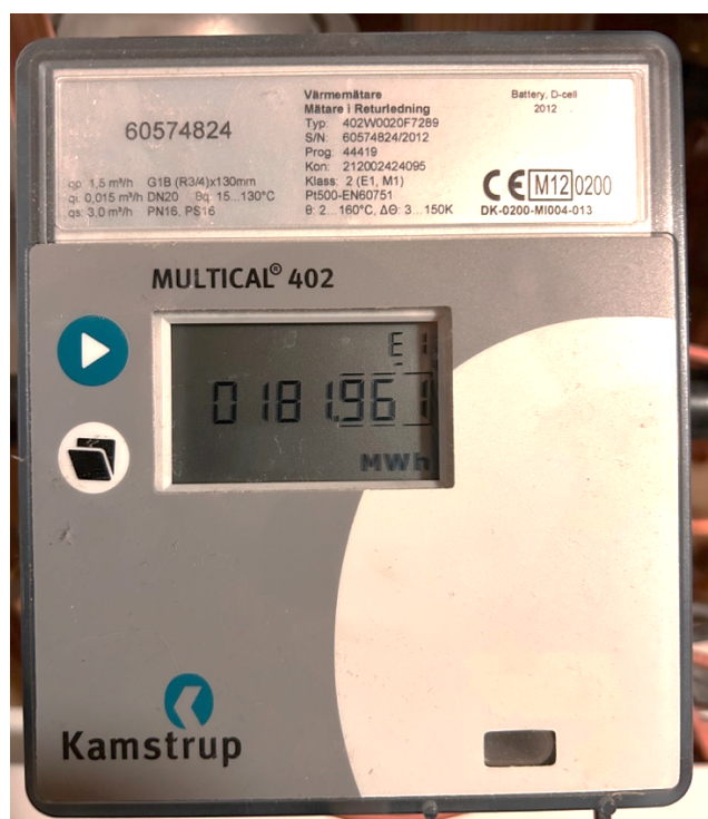
Värmemätaren visandes värmeförbrukning (MWh)
